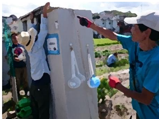
道具を収納するロッカーも倒れてしま ったので固定し立て直しています。
